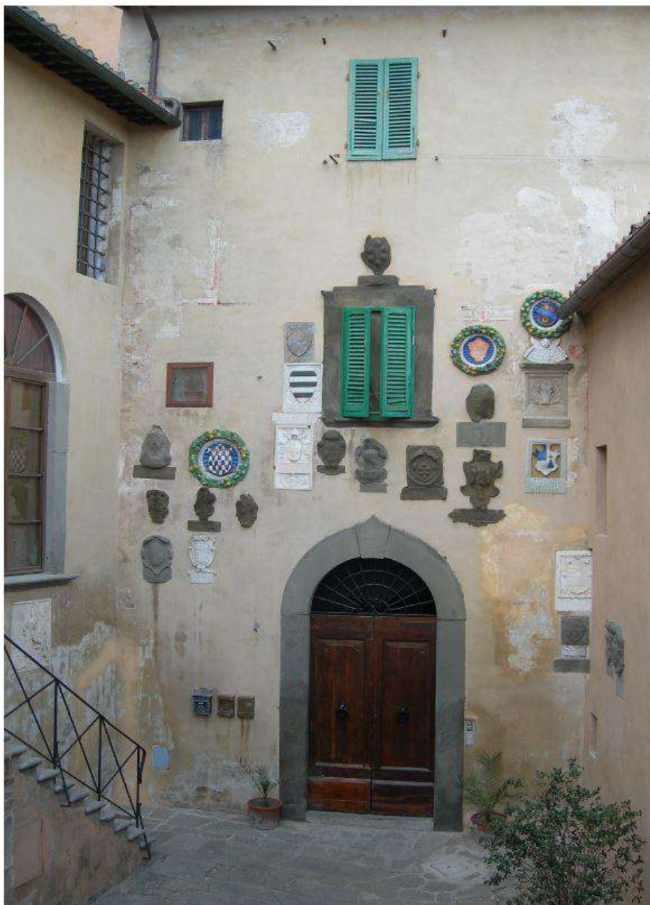
Cortile interno palazzo Pretorio porta ingresso P.T. e finestre zona giorno appartamenti piano 1° e 2°
