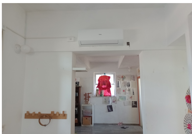
P.T. Split 1 condizionamento aria
