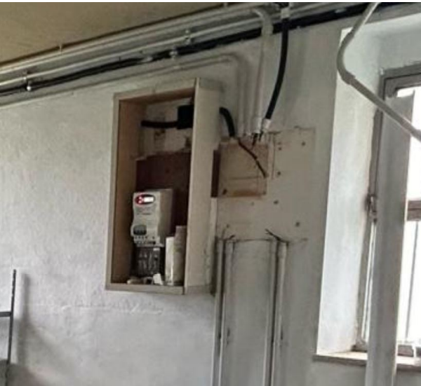
Particolare vano Q.E.
