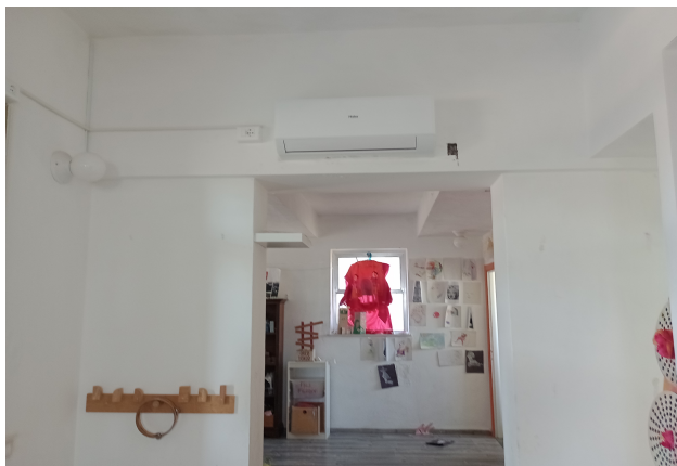
P.T. Split 1 condizionamento aria
